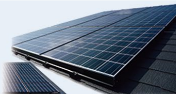
太陽光パネル
